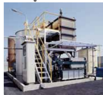
排水処理設備
